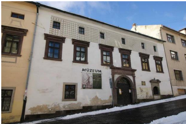
Poškodené omietky na fasáde, Kammerhof
