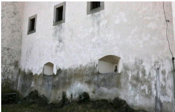
Poškodené soklové omietky, Nový zámok
