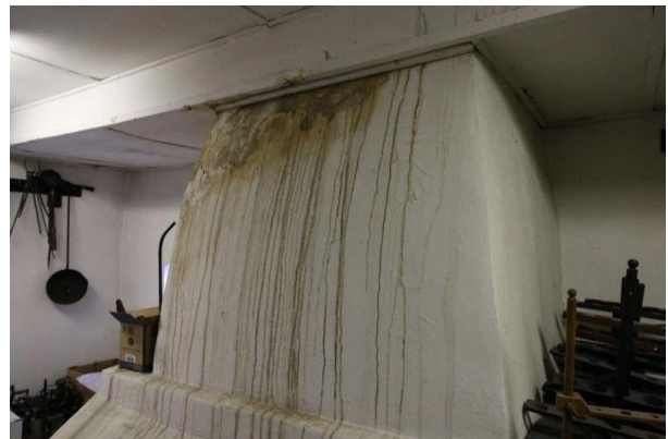
Zatekanie do vnútorných priestorov, Kammerhof
