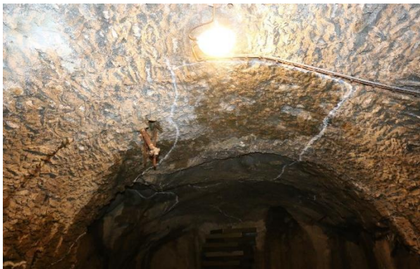
Zatečené pivničné priestory, Galéria J. Kollára
