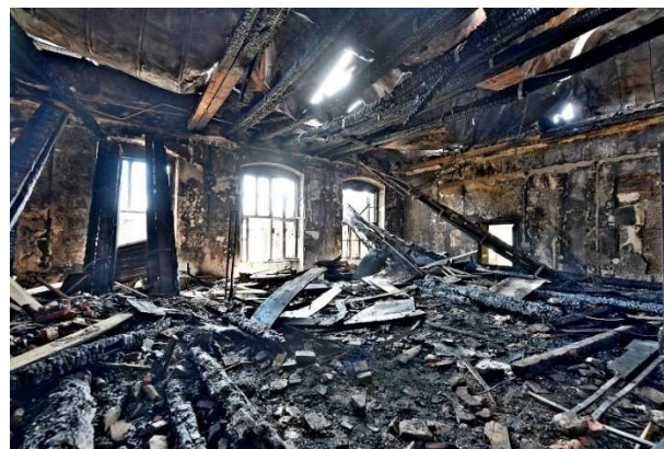
Následky požiaru – zničená štvrtá expozičná miestnosť v Berggerichte, 19.3.2023 foto: Lubomir Lužina
